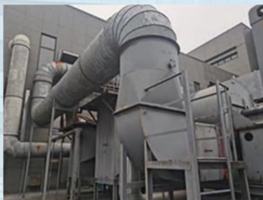
喷漆车间废气处理RCO技术设施
