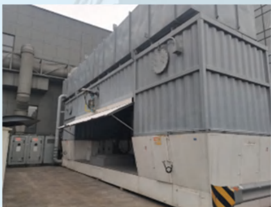
喷漆车间废气处理RTO技术设施
